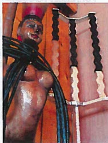
Kabelholdere kan realiseres på mange måder. Her er en af de mere interessante. Bag kabelholderen ses en såkaldt "holograf", der skal forbedre akustikken...
