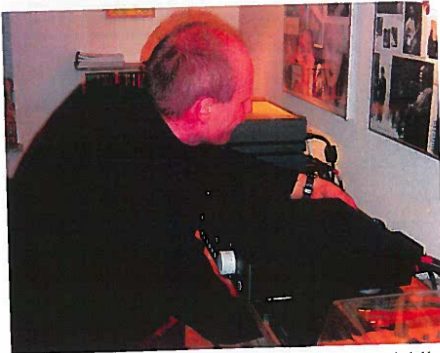
Morten havde flere gange fat i kablerne, når der skulle skiftes rundt. Her er det kablerne ned til effektforstærkerne der igen skal skiftes.
